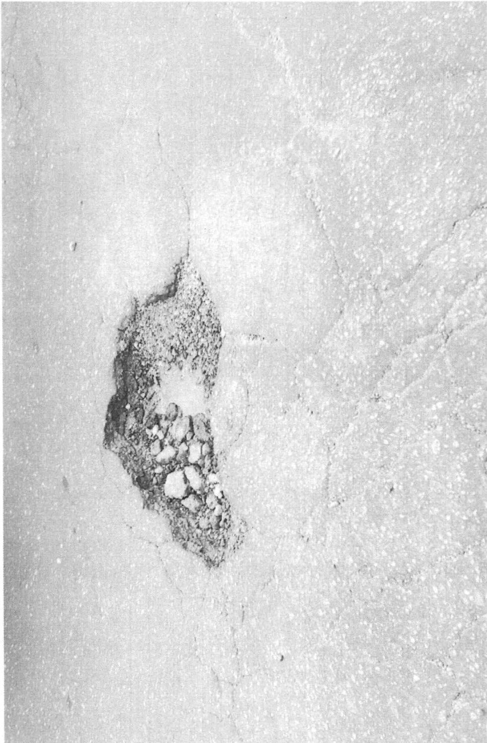
TAPA-BURACO NA RUA THULLER COM A RUA DOM LUIS DE SOUZA, JARDIM UNIVERSO
