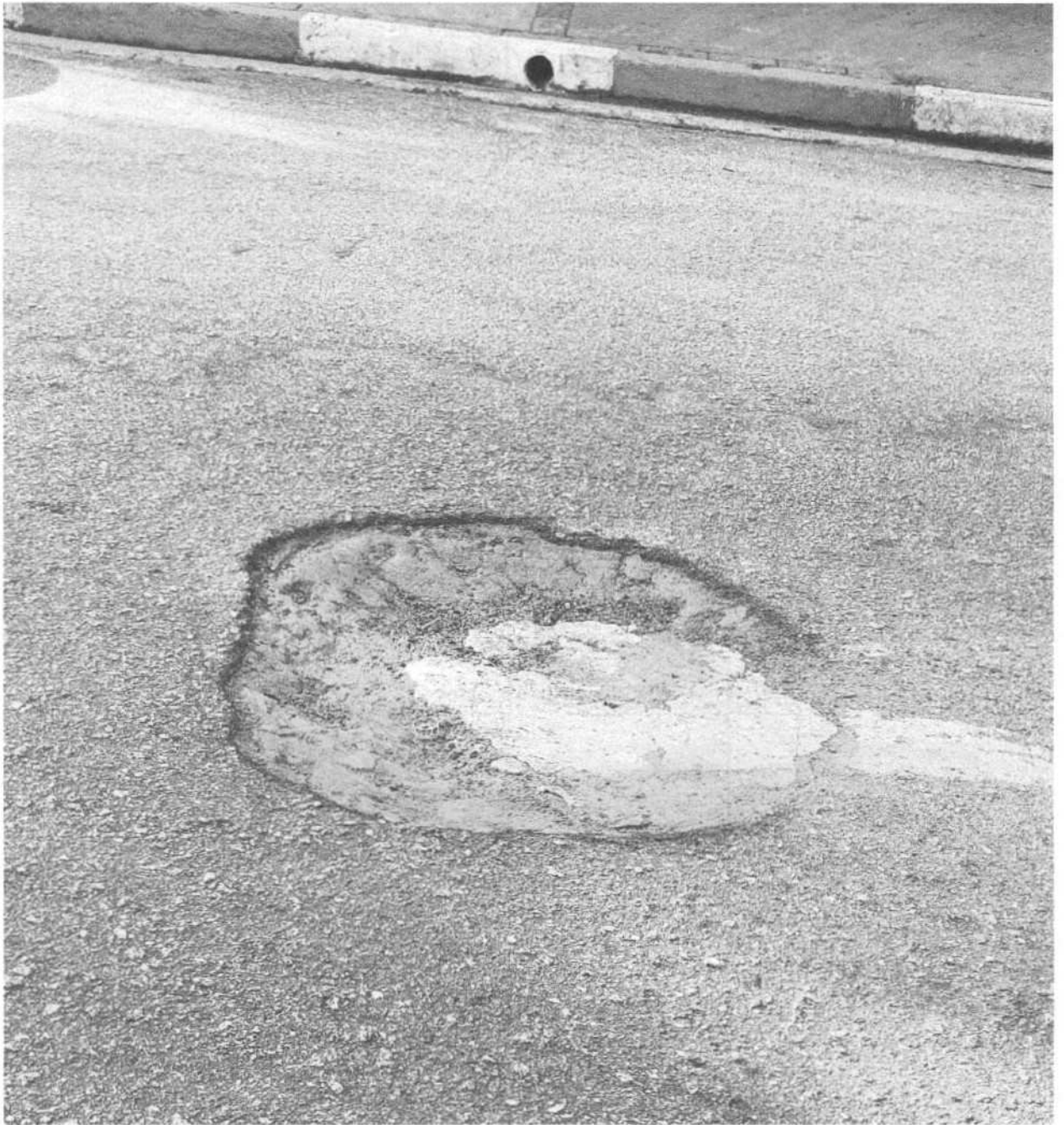
TAPA-BURACO EM TODA EXTENSÃO DA RUA OSCAR ERXELEBEN, VILA NOVA CINTRA – MOGI DAS CRUZES.
