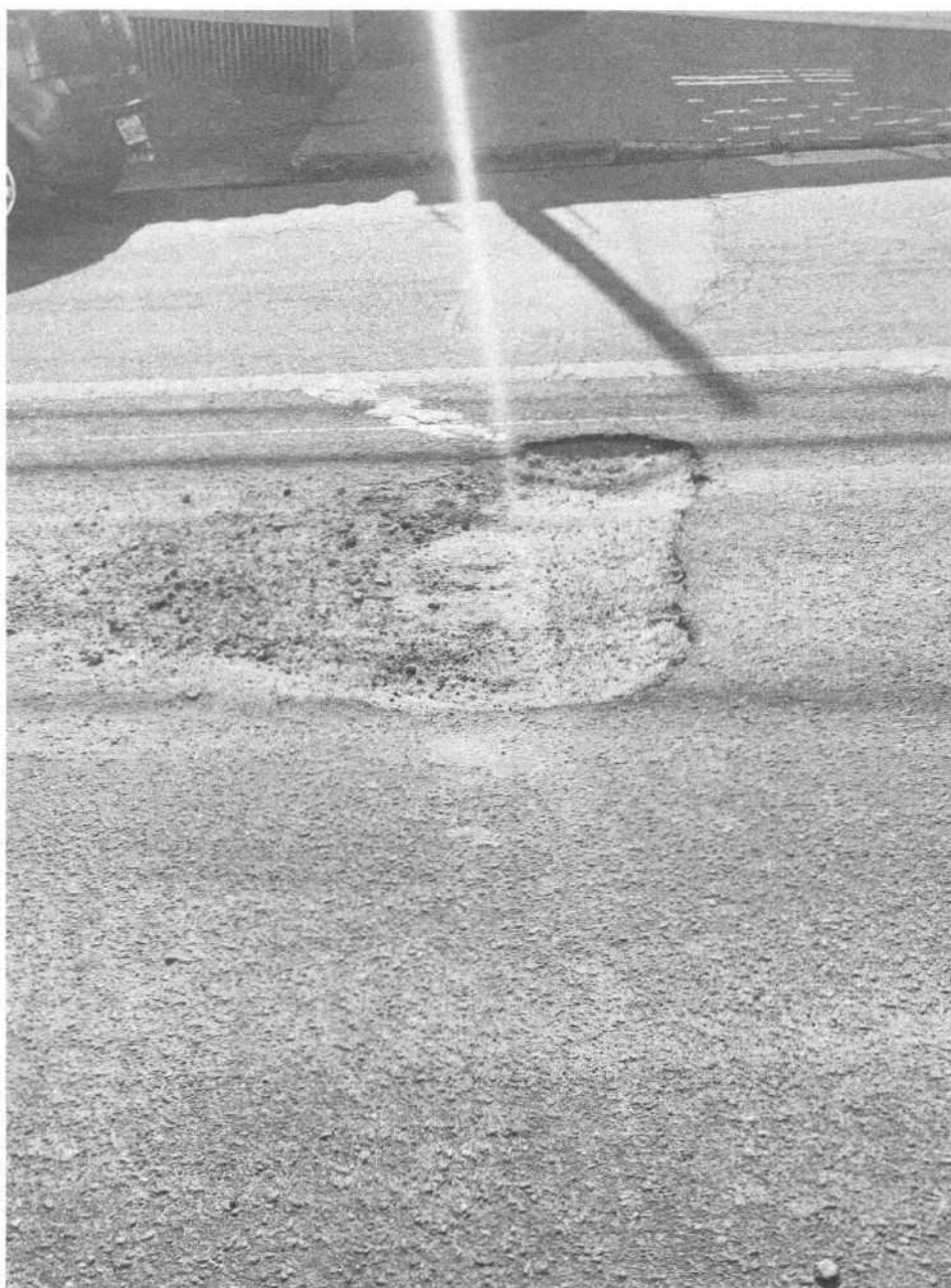
TAPA-BURACO EM TODA EXTENSÃO DA RUA PAULO EDUARDO DO VALLE PEREIRA, VILA NOVA CINTRA.
