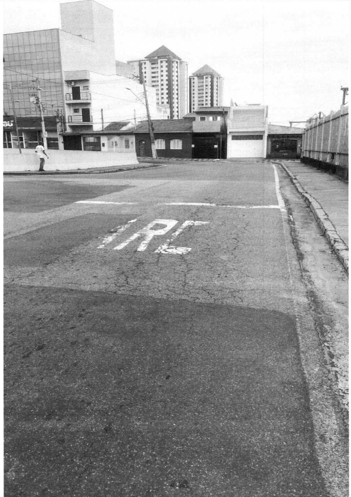
Foto 02- Sinalização de solo desgastada
