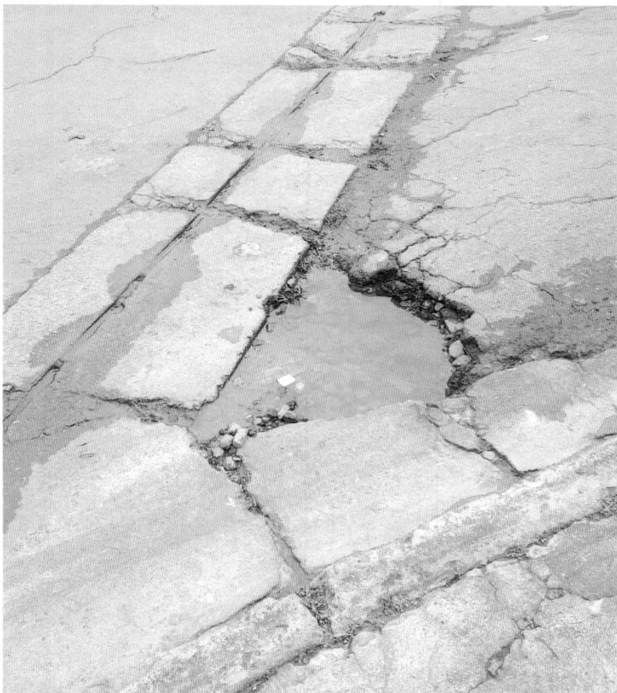
TAPA-BURACO EM TODA EXTENSÃO DA RUA ADEMAR BONAFÉ, VILA JUNDIAÍ – MOGI DAS CRUZES.
